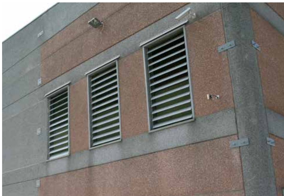
Messa in sicurezza dell'esterno del magazzino alla Latteria San Valentino di Marcaria
